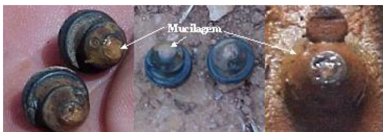
Figura 7 - Formação de mucilagem na entrada dos gotejadores e nas paredes internas das tubulações.
